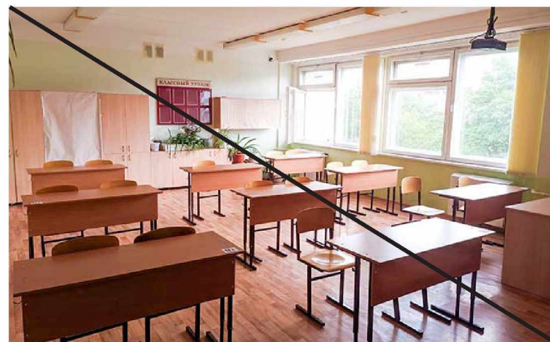
Плохо Линолеум под дерево
